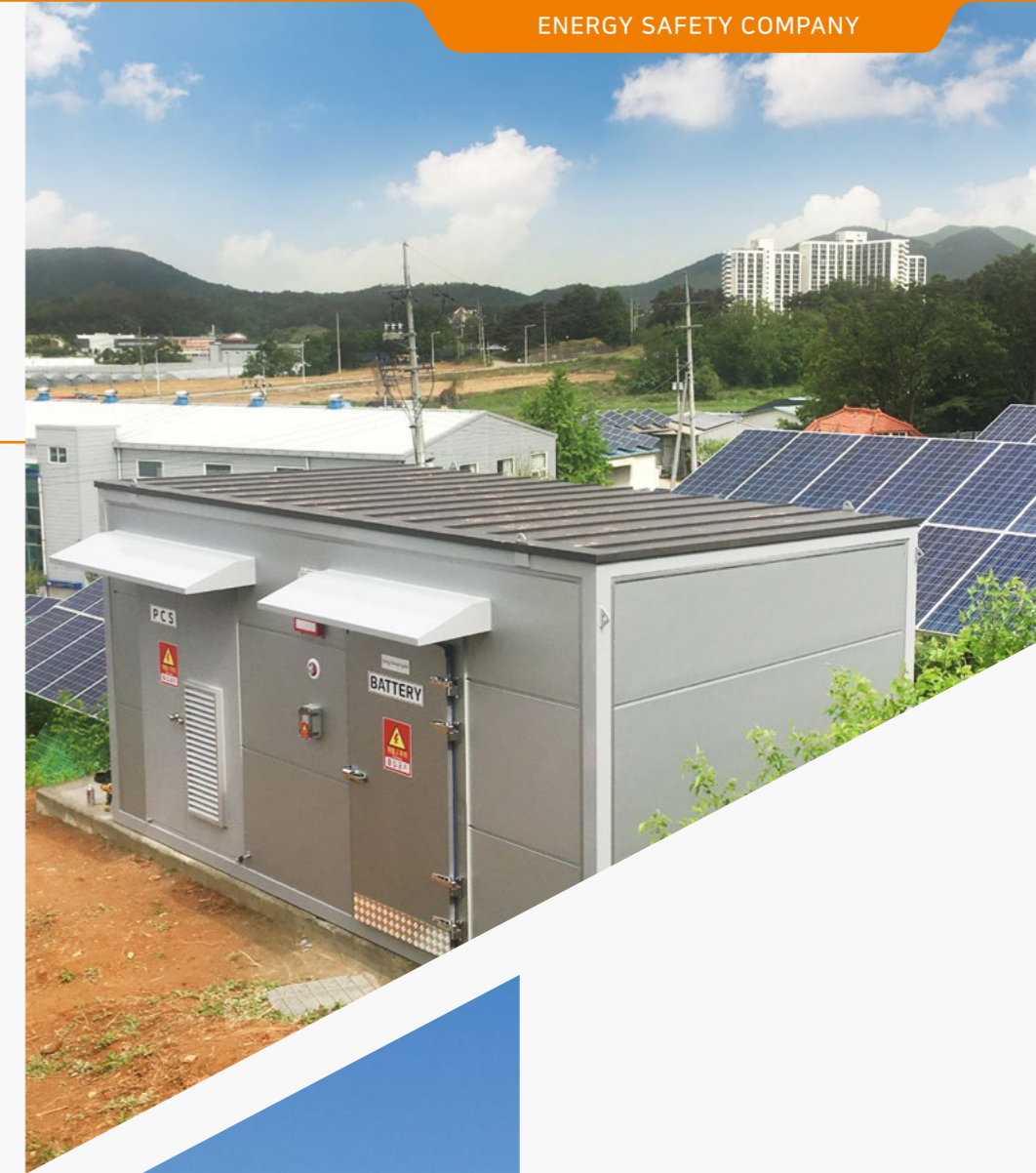
경상북도 군위군 태양광 연계형 ESS
