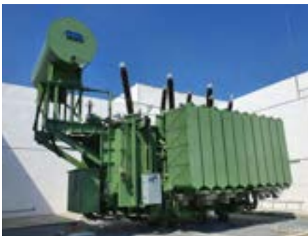
튀니지, 3상 225kV 200MVA
