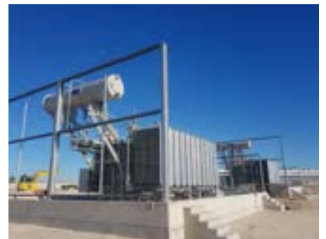
호주, 3상 132kV 45MVA
