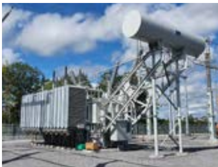
미국, 3상 500kV 350MVA
