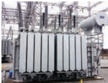
미국, 3상 345kV 448MVA
