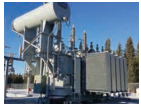
캐나다, 3상 138kV 42MVA
